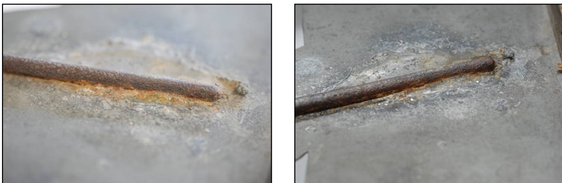
Fig. 148 : Détail d'une brasure présentant des coulures de produits de corrosion du fer : avant et après nettoyage.
