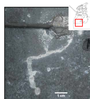
Fig. 98 : Chlorure de zinc situé près des brasures. Les produits de corrosion suivent les coulures de flux. © G. Vanneste.
